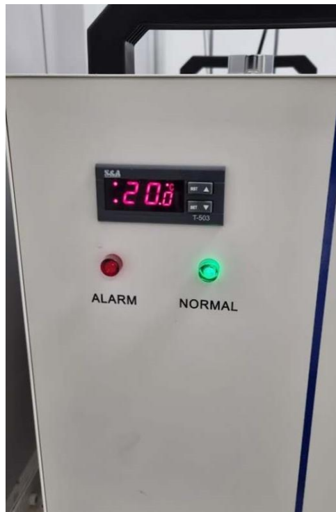
Chiller levegő hűtő egység /Chiller air cooling unit
